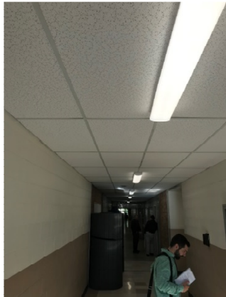
E15 – Corridor Lighting
