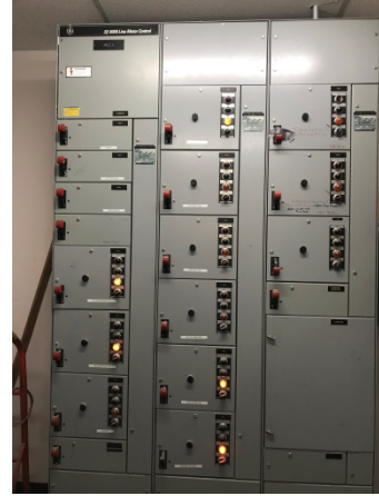
E14 – Motor Control Center
