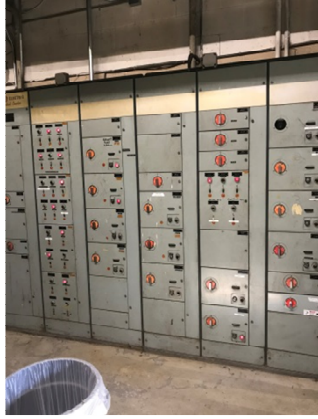
E13 – Motor Control Center
