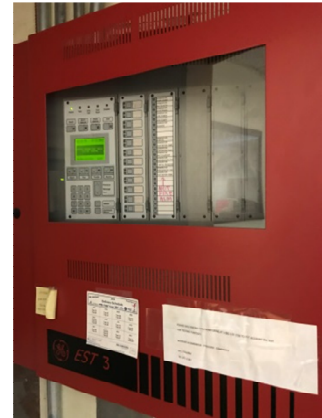
E10 – Main Fire Alarm Panel
